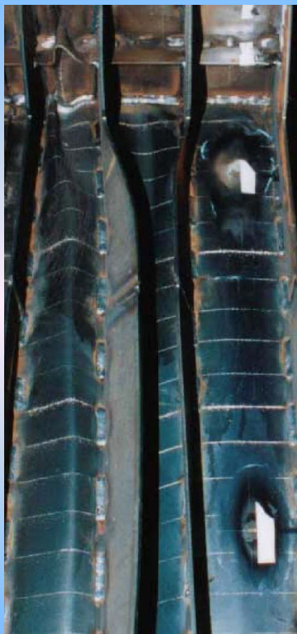
船側外板上部の座屈崩壊
