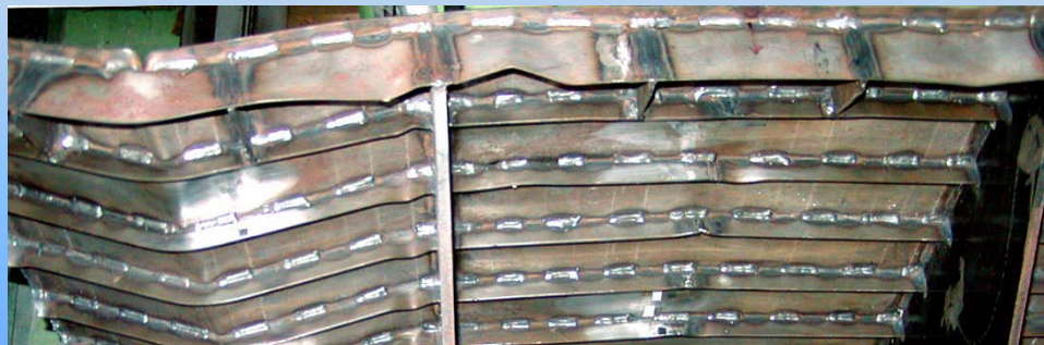
甲板の全体座屈崩壊
